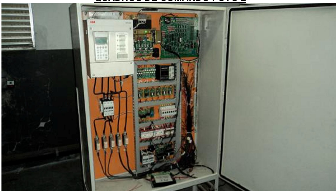
QUADROS DE COMANDO FOTO 2
