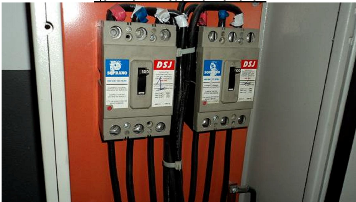
QUADRO DE DISJUNTORES FOTO 2
