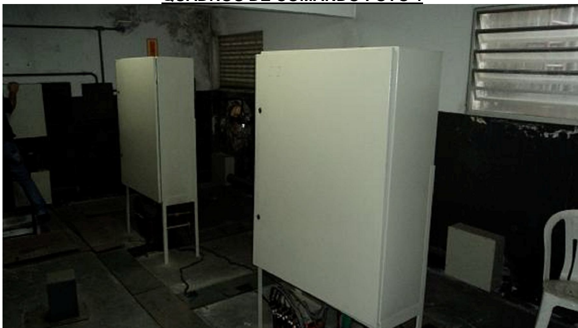
QUADROS DE COMANDO FOTO 1
